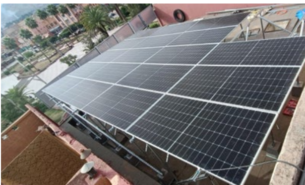
Centrale solaire Beni-Mellal Agence Principale
