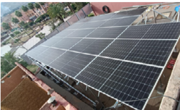
Centrale solaire Beni-Mellal Agence Principale
